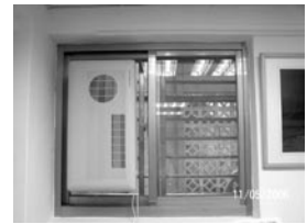
一樓辦公區全熱交換空氣對流機, 有新鮮空氣量和相對耗電考量問題
