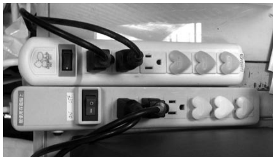
裝設個別電源控制開關
