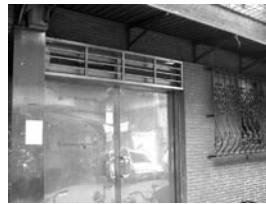
後鐵門上方開窗太小, 通風量還是不足, 可考慮在鐵門上再開窗
