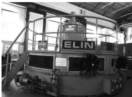
▲圖2 小粗坑水力發電廠三號發電機
