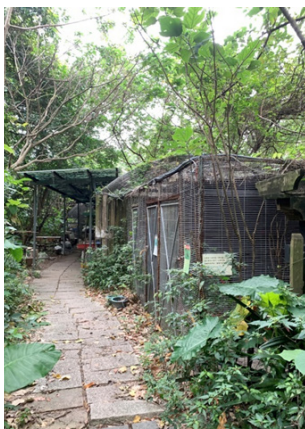
▲ 角鋼鏽蝕嚴重
