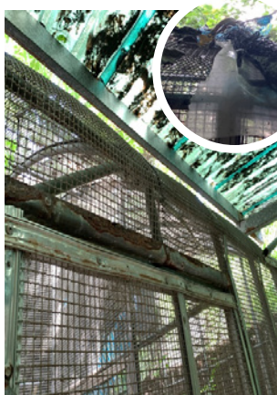
▲ 門框鏽蝕、遮光布破損嚴重
